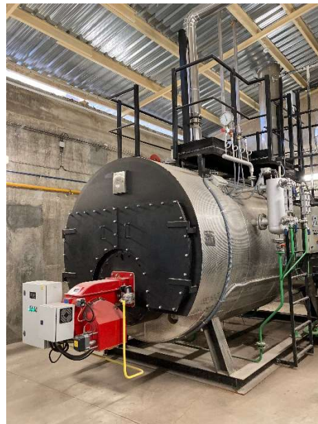
Ilustración 13. Caldera de vapor.
